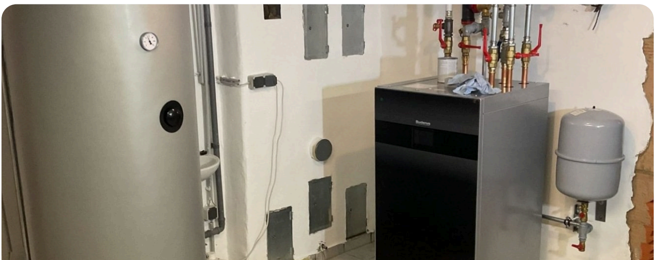
Aus unserer Praxis: Wärmepumpen-Inneneinheit mit Warmwasserspeicher im Bestandskeller
