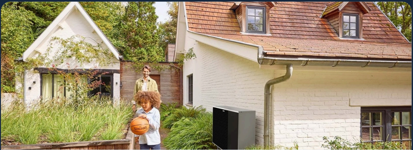
Luft/Wasser-Wärmepumpe: Außeneinheit an der Hausfassade · Fotocredit: Daikin
