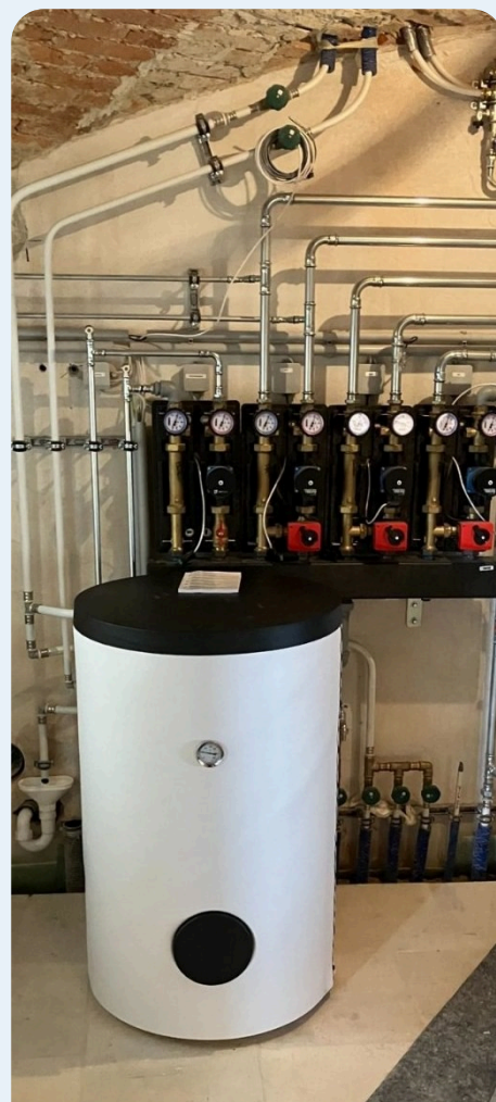
Aus unserer Praxis: Speicher und Heizkreisverteilung im Gewölbekeller
