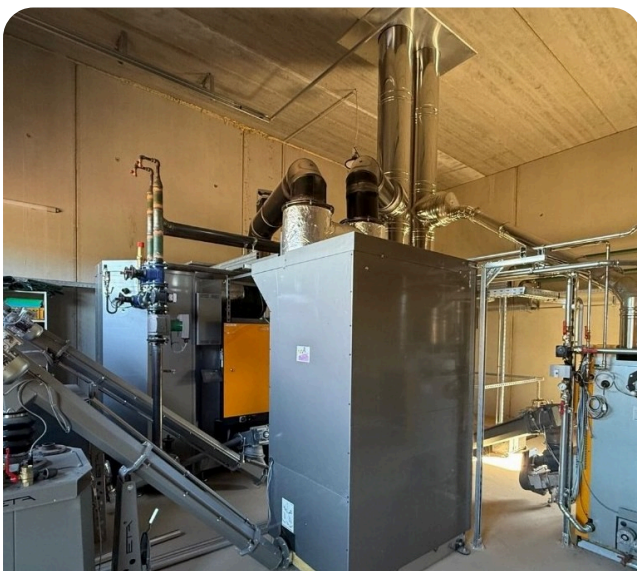
Aus unserer Praxis: Biomasse-Nahwärmezentrale
