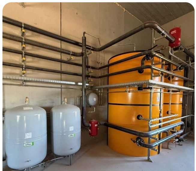
Pufferspeicheranlage der Nahwärmezentrale
